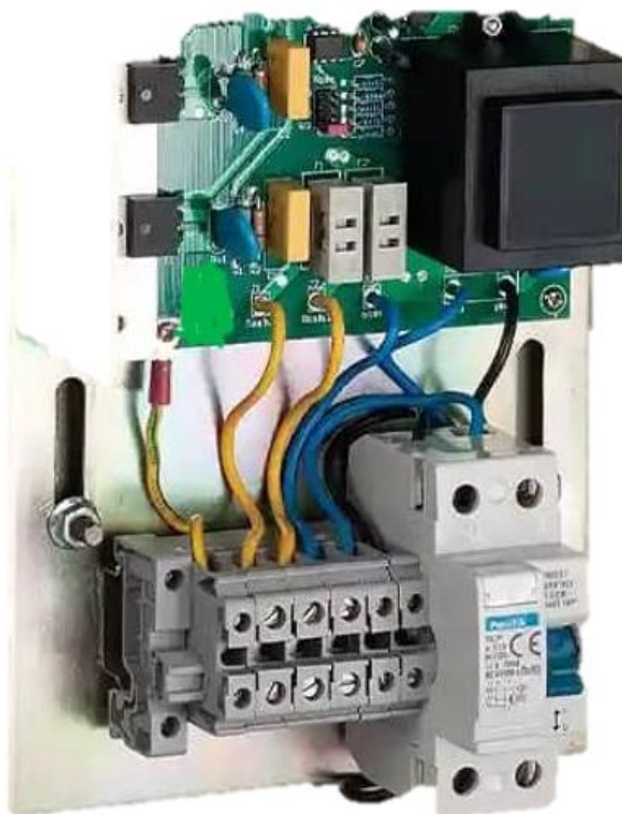
شکل ۳۴-۲: نمونه برد اصلی داخل کابینت کنترلر چشمک‌زن برقی
